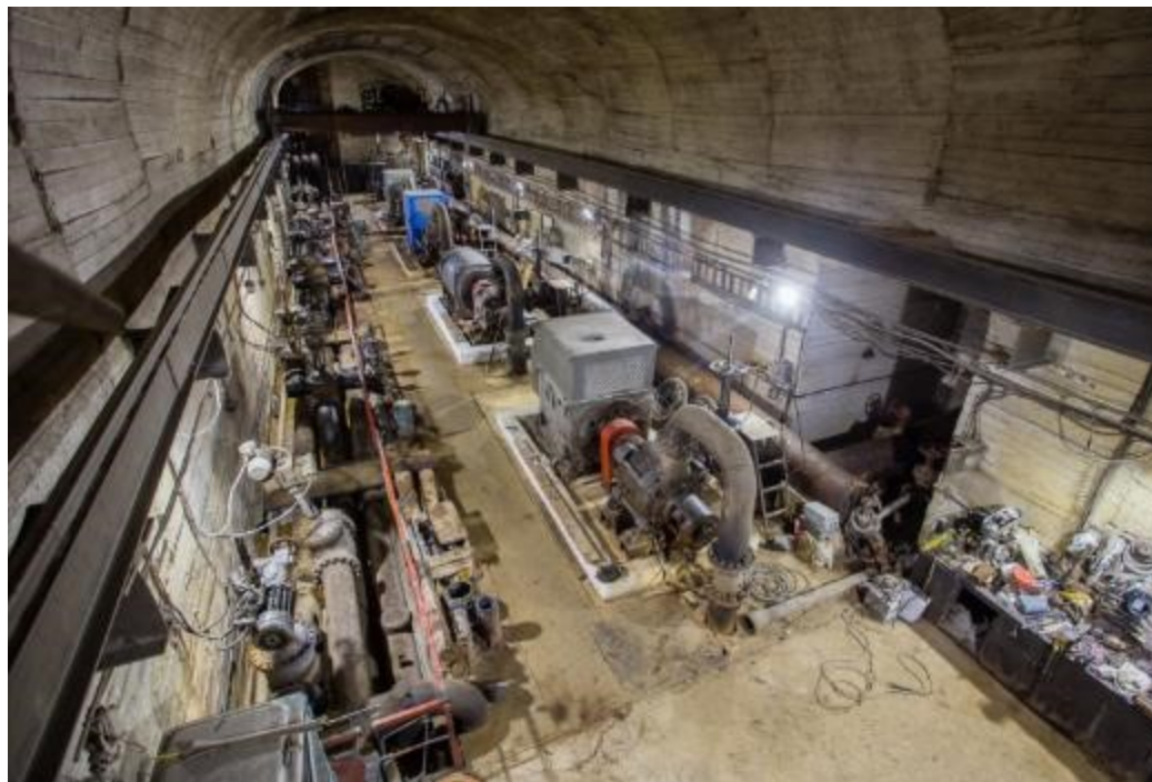
Рисунок 3.18. Насосная камера шахтного водоотлива
