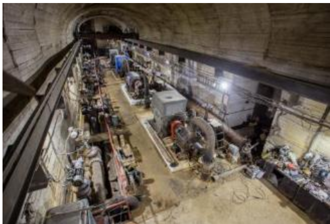
Рисунок .. Насосная камера шахтного водоотлива
